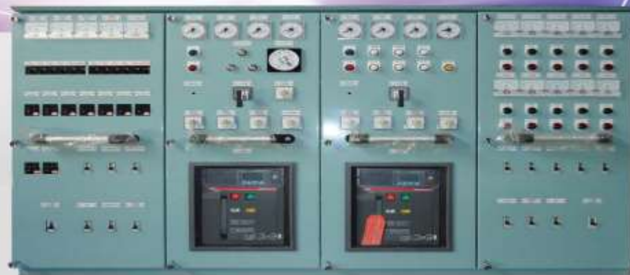
▲ 船舶用配電盤
